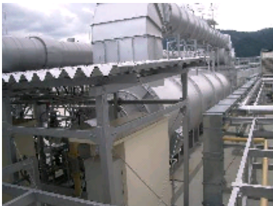
灯油から天然ガスに燃料転換しCO 2 排出量削減へ寄与した有機溶剤脱臭炉
